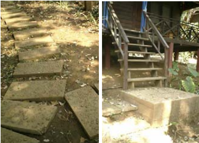
ຂັ້ນໄດ ແລະ ທາງຢ່າງທີ່ຊັນເກີນຂອບເຂດ ຈະເຮັດໃຫ້ແຂກ ພະລາດລົ້ມໄດ້ຢ່າງງ່າຍ ດາຍ.
